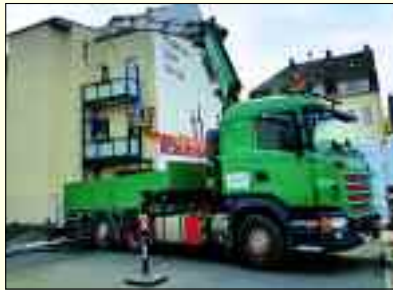
Der Transport und die Montage von Balkonen gehört zu den neueren Geschäftsfeldern.
