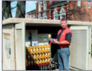
Der Stellvertretende Netzmeister Reiner Eichstädt sorgt für Strom in der Region
