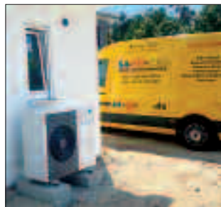
Von Karsten Kube installierte Wärmepumpe (re.) und Warmwasserunterstützung (o.).
