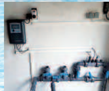
Misst und reguliert den PH-Wert und den Chlorgehalt für optimale Wasserqualität: Moderne Dosiertechnik.
